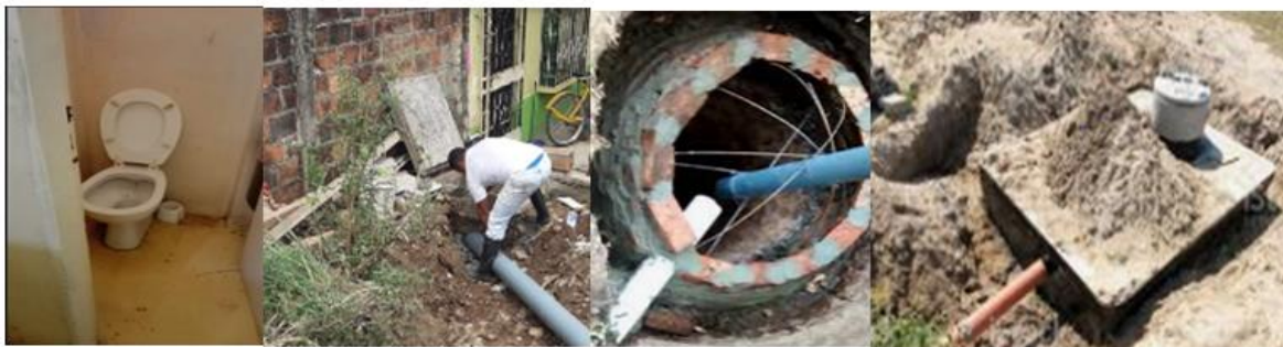
Excusado conectado a pozo ciego
