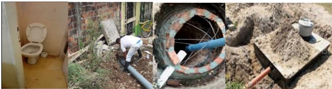
Excusado conectado a pozo ciego
