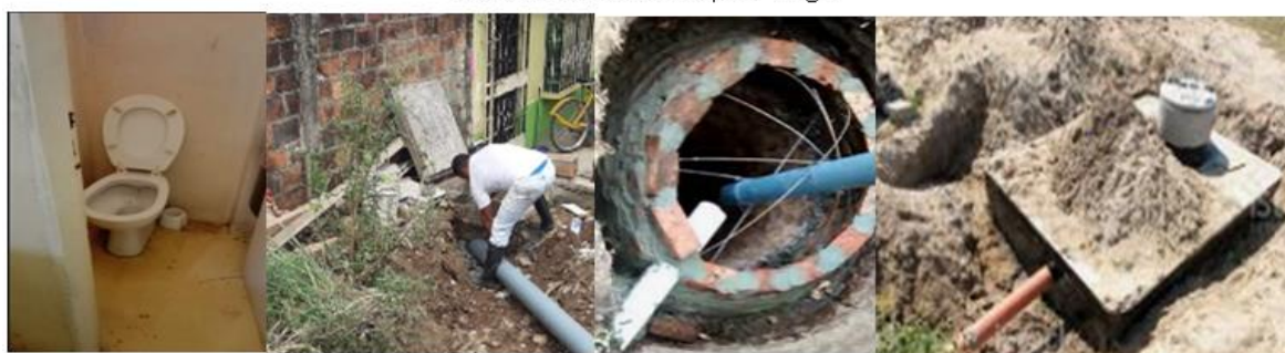
Excusado conectado a pozo ciego
