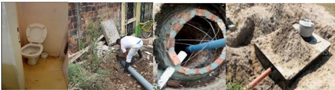
Excusado conectado a pozo ciego
