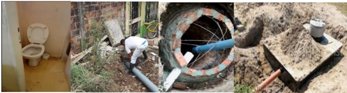
Excusado conectado a pozo ciego
