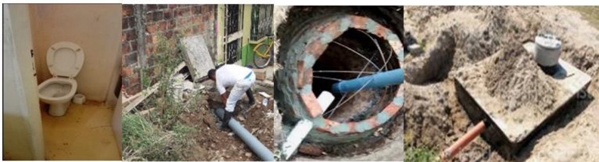
Excusado conectado a pozo ciego
