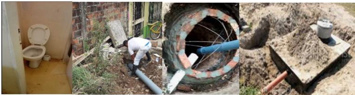
Excusado conectado a pozo ciego
