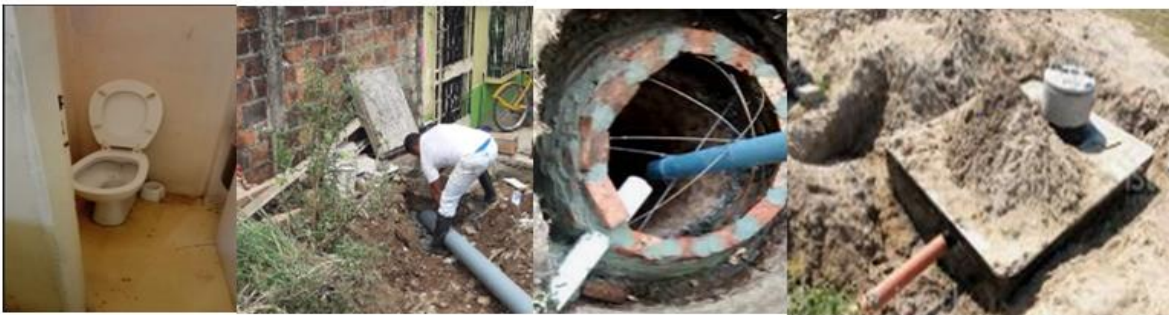
Excusado conectado a pozo ciego
