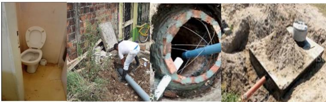
Excusado conectado a pozo ciego
