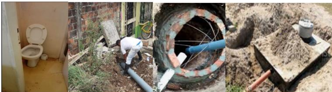
Excusado conectado a pozo ciego
