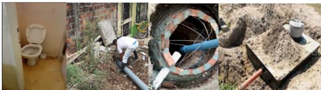
Excusado conectado a pozo ciego
