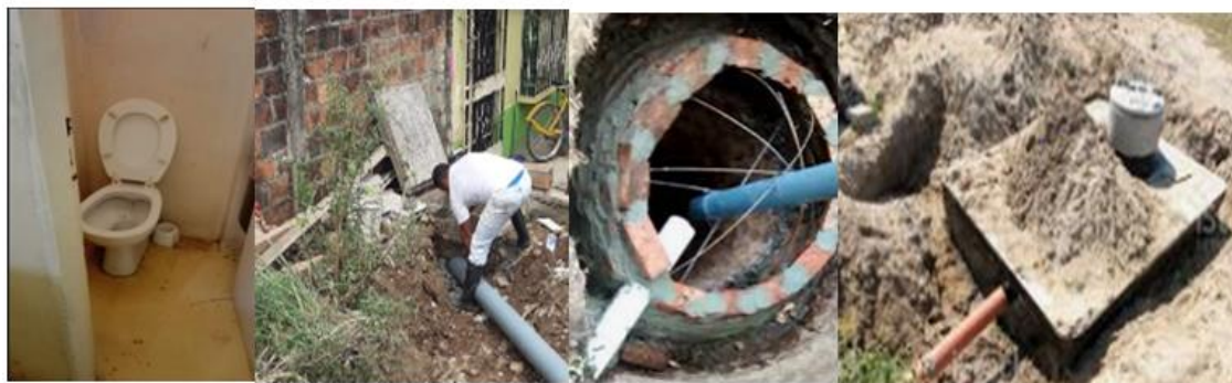
Excusado conectado a pozo ciego
