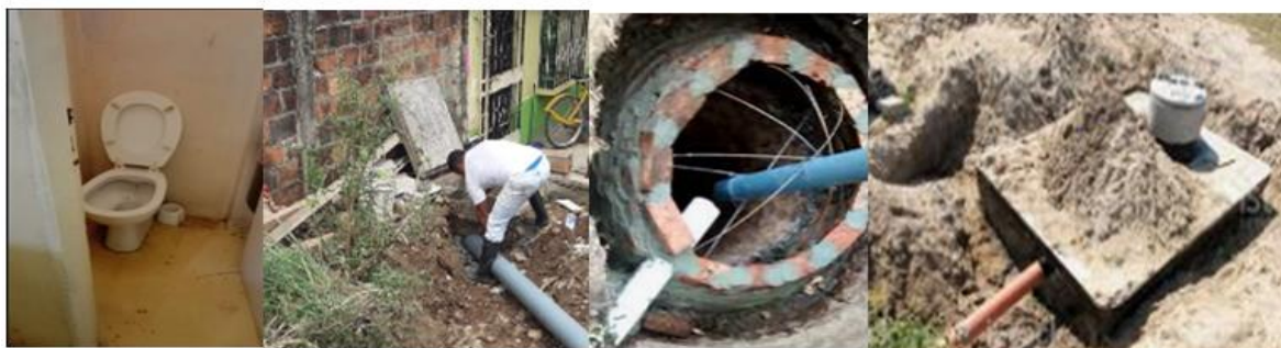
Excusado conectado a pozo ciego
