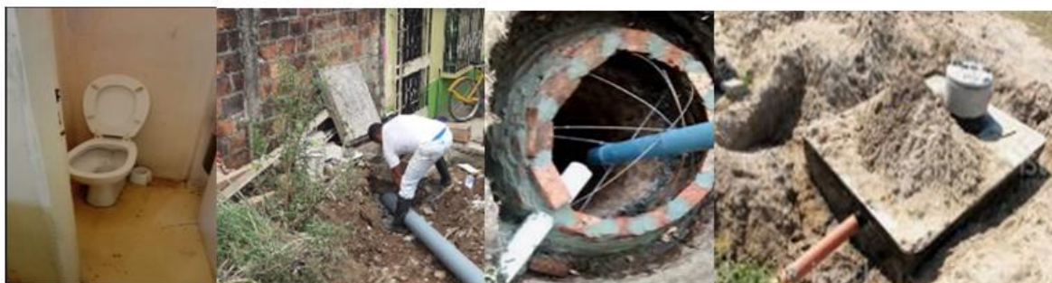
Excusado conectado a pozo ciego
