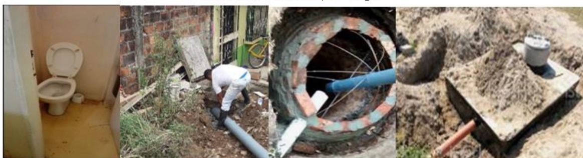
Excusado conectado a pozo ciego
