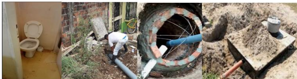
Excusado conectado a pozo ciego
