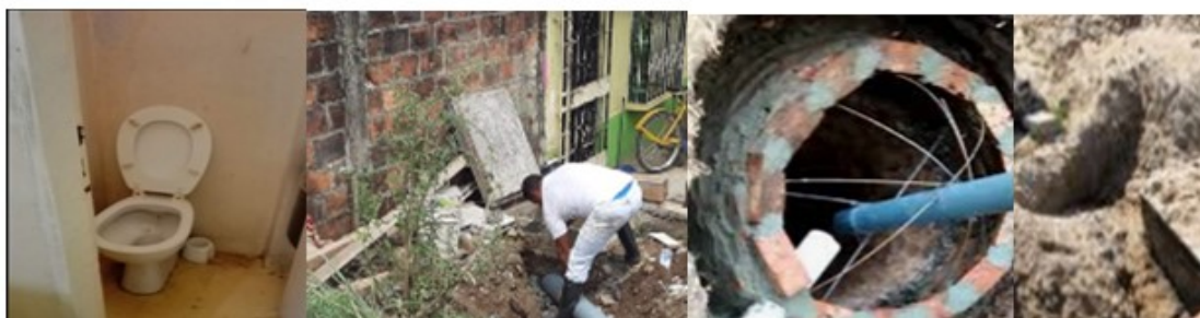
Excusado conectado a pozo ciego
