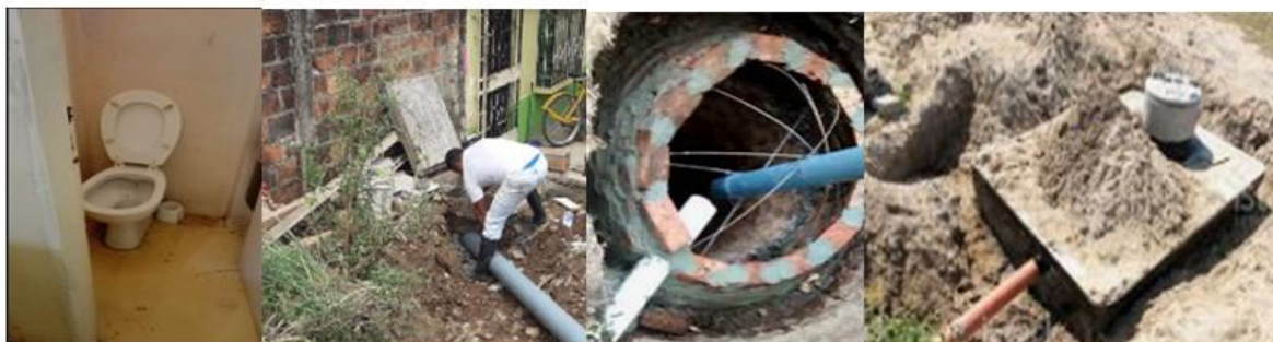
Excusado conectado a pozo ciego
