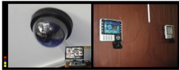
Cámaras de Seguridad y Control Electrónico de Entrada y Salida del Personal
